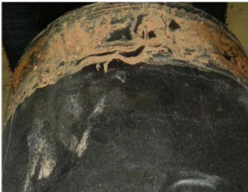
Фиг. 3. Мръсотия и кал в зоната на тръбата и муфата, където е трябвало да се случи сливане между 2-та полиетилена.
